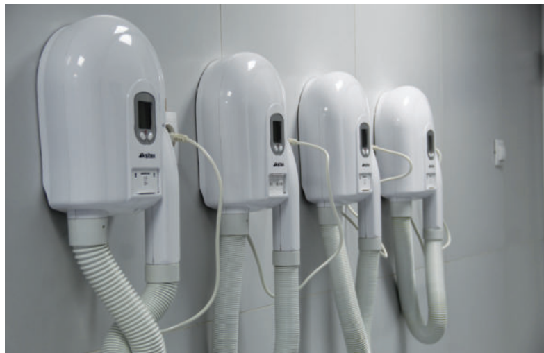
Для комфорта в бытовых помещениях установлены фены.
